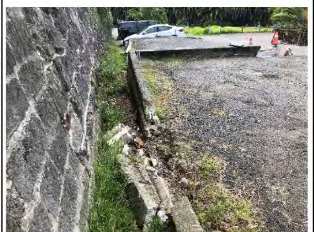
Photo 6) Broken top barrier.
