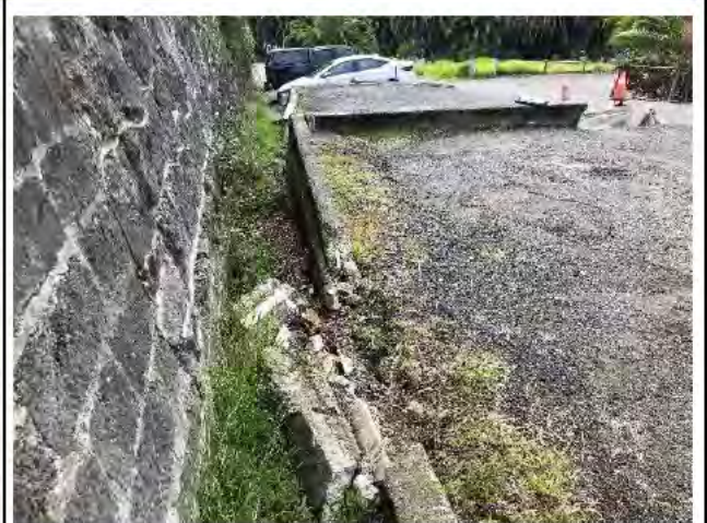
Photo 6) Broken top barrier.
