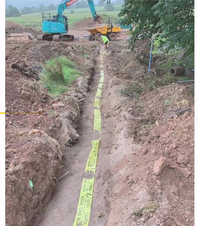
HV electrical cable
